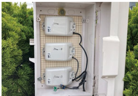
能美市様 毎日単位の超過流量を把握する必要がある 工業用水給水先へ設置。
