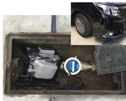
大阪市水道局様 実証実験 鉄製蓋の上に駐車している状態での通信。
