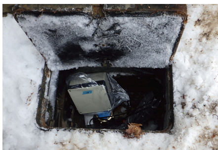
松本市上下水道局様 山間遠方地などの難検針給水先へ設置。
