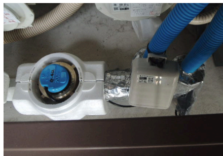
横浜市水道局様 モデル事業 325件大規模マンションへ設置。
