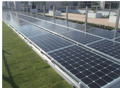
三菱電機(株)製パネル 発電容量10.962kW
