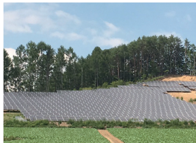
三菱電機(株)製パネル 発電容量1016.4kW
