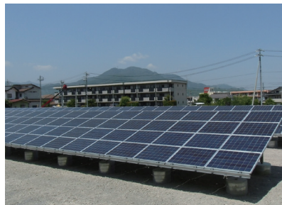
シャープ(株)製パネル 発電容量106.08kW
