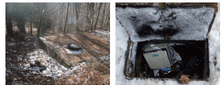
松本市上下水道局様 実証実験 (山間遠方地などの難検針給水先へ設置)
