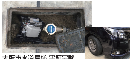
大阪市水道局様 実証実験 (鉄製蓋の上に駐車している状態での通信)
